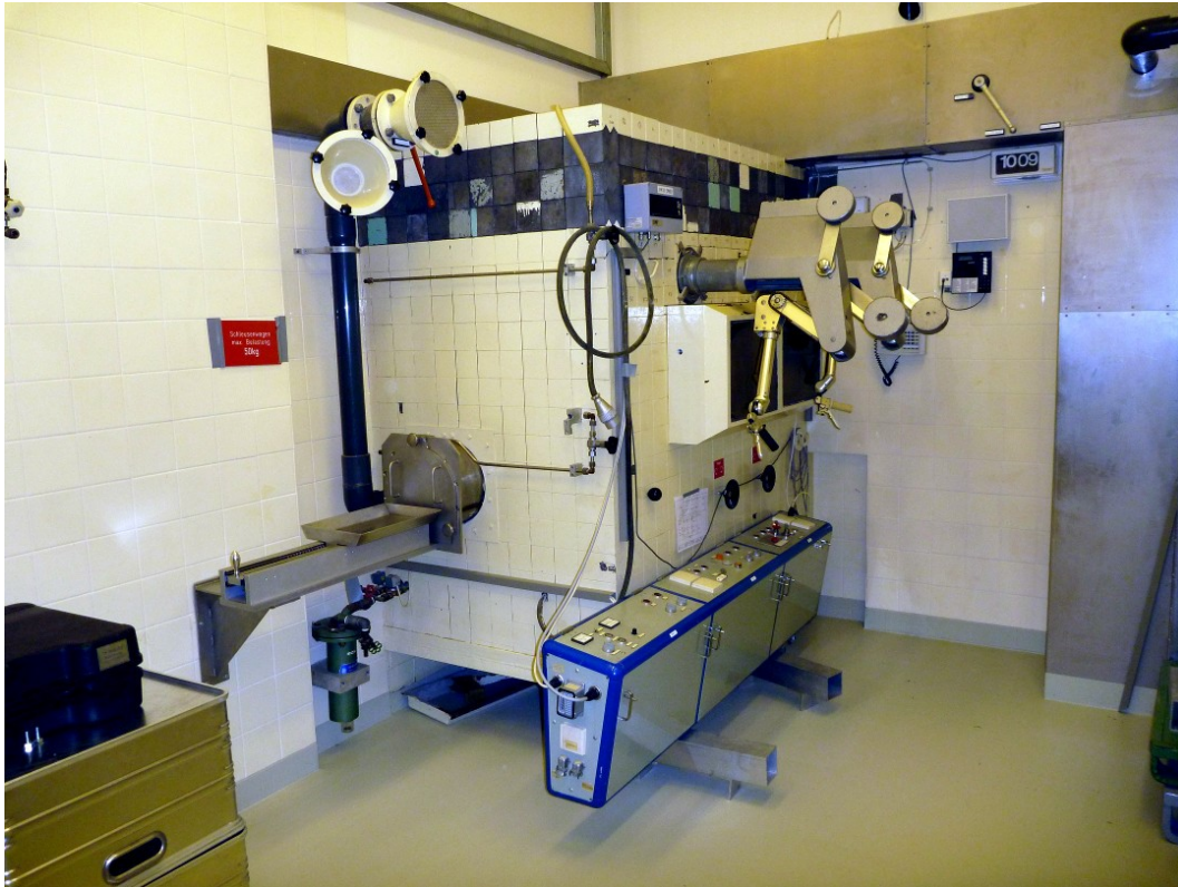
Abbildung 7-1: Bleizelle 1 mit Manipulatoren und Bleiglasfenstern
