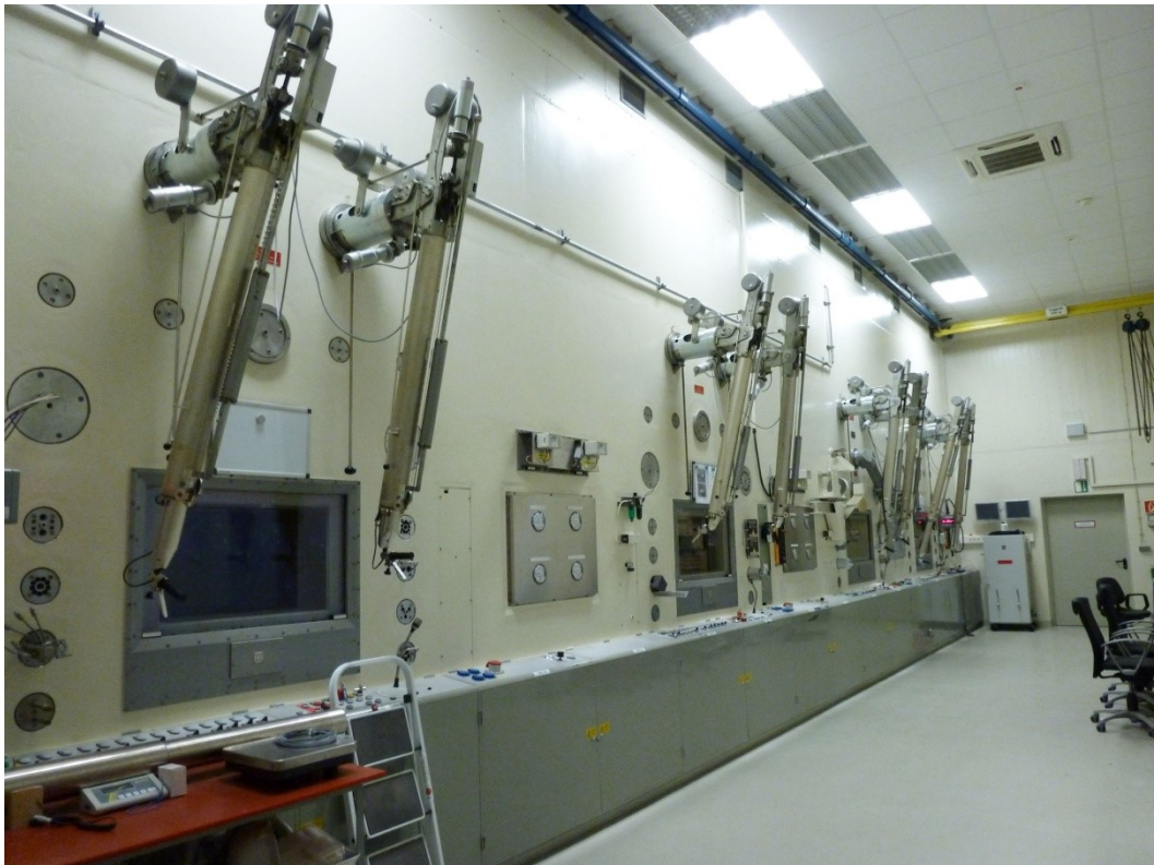
Abbildung 7-2: Bedienraum mit Blick auf die Manipulatoren und Bleiglasfenster
