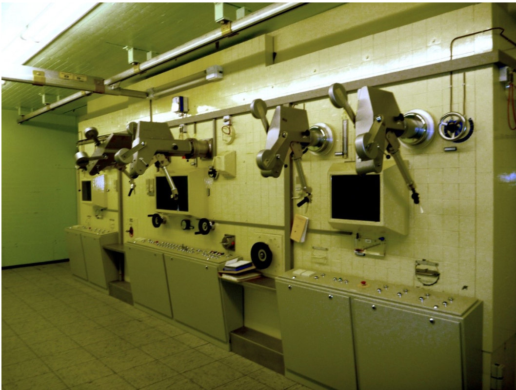
Abbildung 7-4: Dosimetriezellen mit Manipulatoren und Bleiglasfenstern
